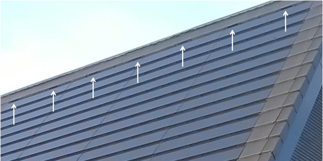
Figuur 3 Foto van ventilatiedakpannen boven een Solinso Mystiek zonnestroominstallatie.
